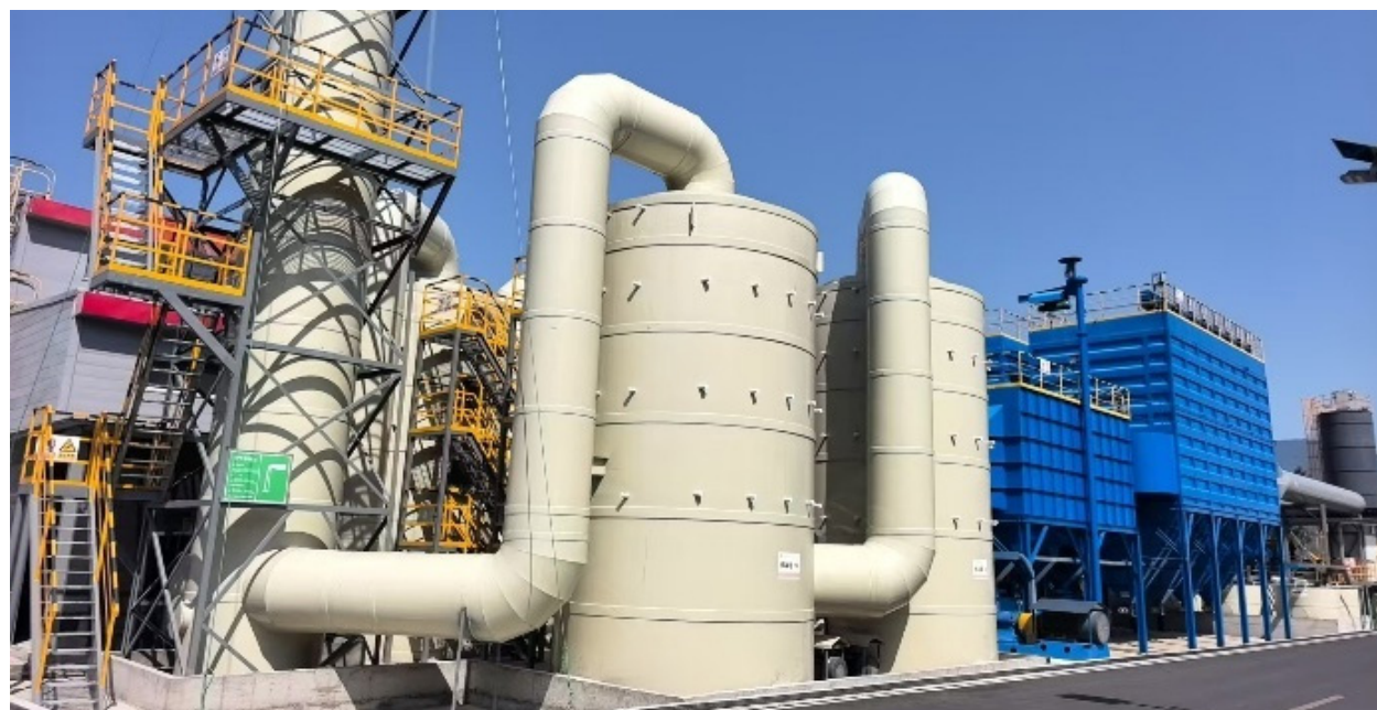
磁材公司除尘除氟治理设施
