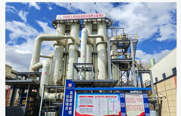
龙南冶炼 MVR 高盐废水处理站
