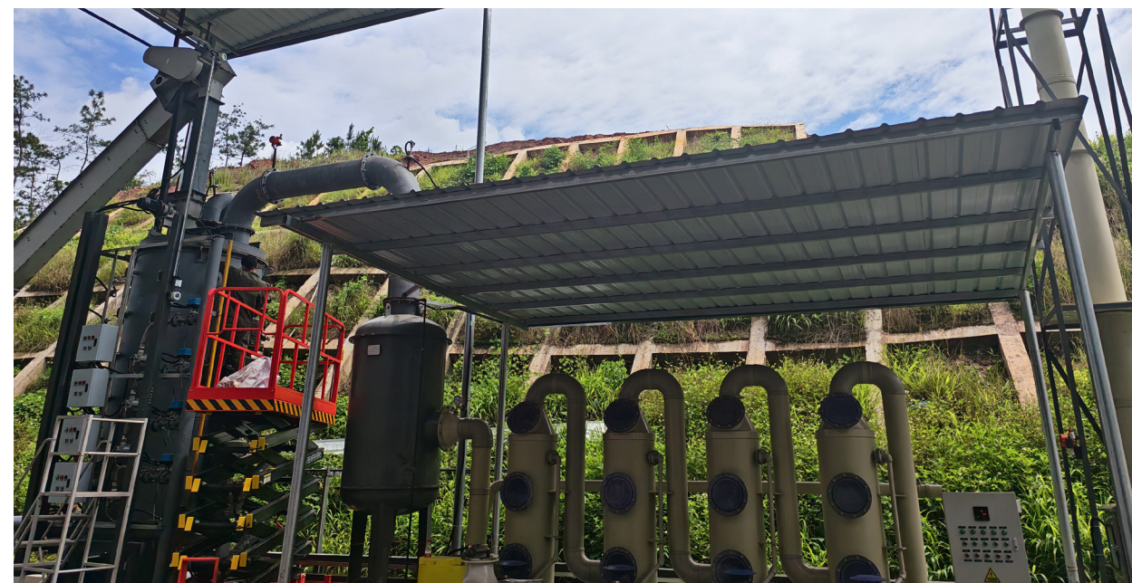
赣州友力熔盐渣中试设备
